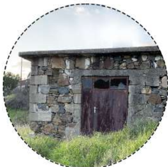
Υπαρξη μεταγενέστερων στοιχείων (σκυρόδεμα)
