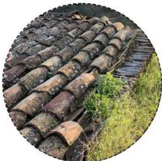
Καταστροφή κεραμιδιών - ελλειπές κομμάτι οροφής
